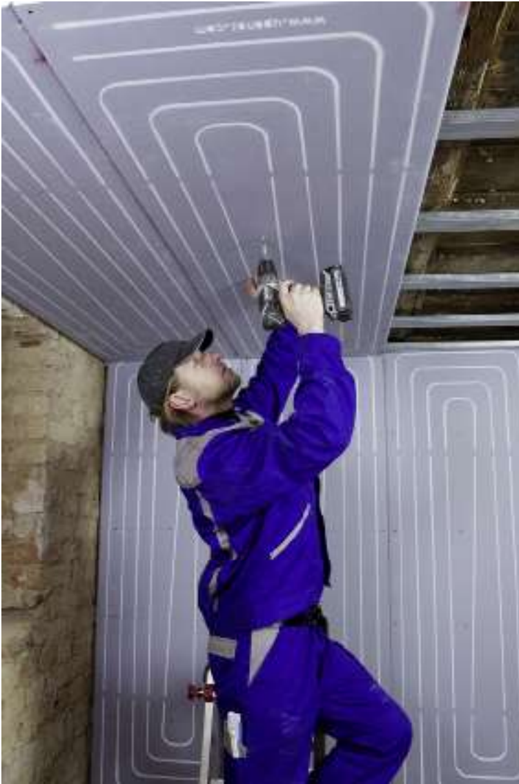
Abbildung 5 – Die Flächenheizung/-kühlung ermöglicht das Zusammenspiel unterschiedlicher Flächen mit zwei Funktionen in einem System: Heizen und Kühlen;
