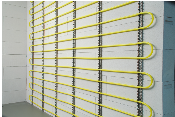
Abbildung 3: Ansicht einer Wandheizung/-kühlung mit gleichmäßigen Verlegeabständen vor dem Aufbringen der Wärmeverteilschicht (Wandputz) in Nassbauweise, Quelle: BDH
