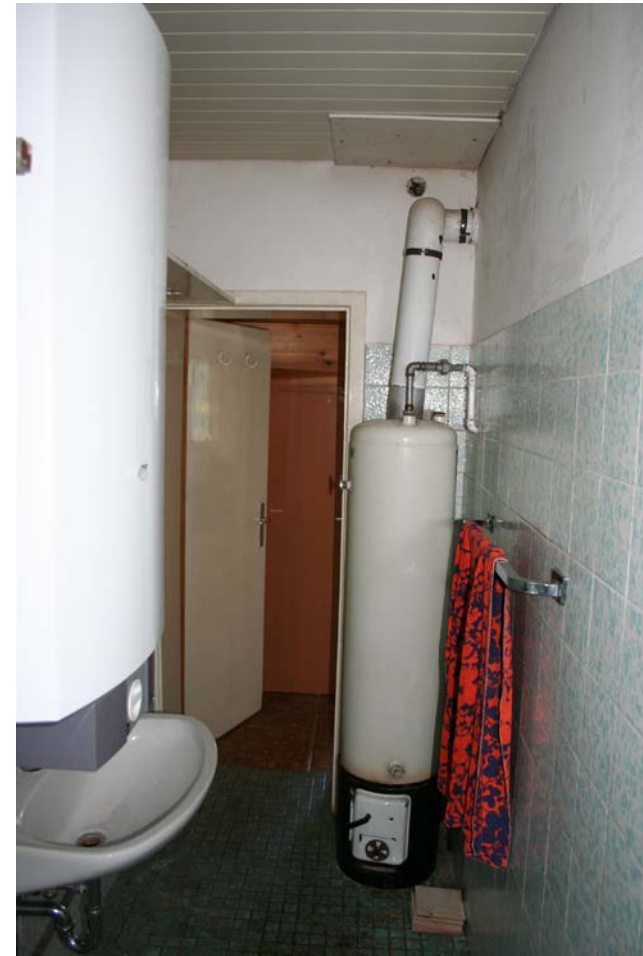
Warmwasserversorgung Bestand: Holzboiler und Elektroboiler
