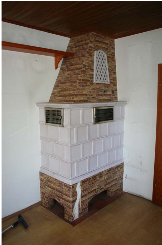
Heizung Bestand: Kachelofen mit Ölofeneinsatz
